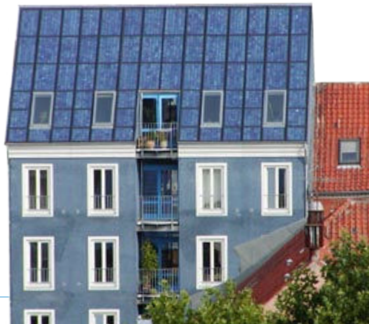
Solcelletag på Tøjhushavevej 5, Randers.
